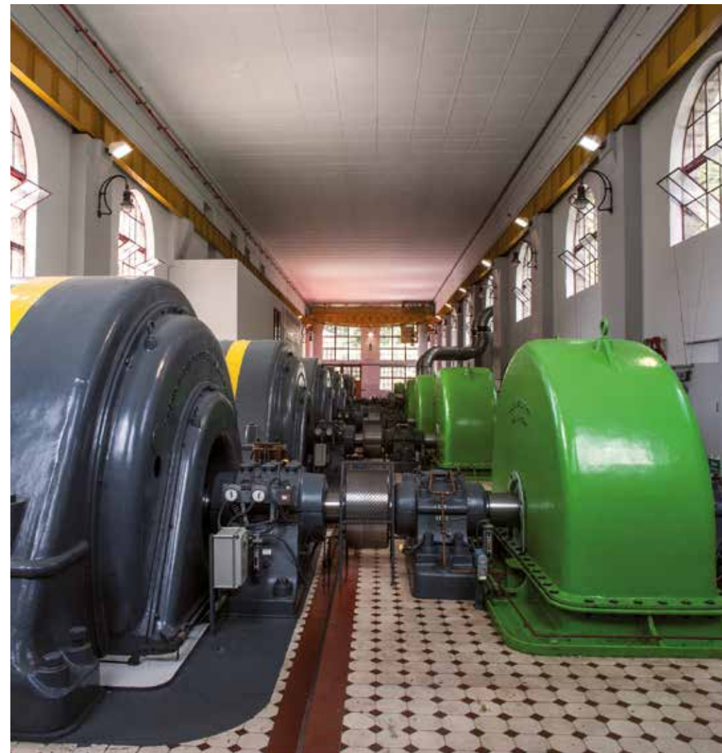
La Central Hidroelèctrica de Capdella, que ara és també museu, la primera a fer llum al Pirineu, encara està en actiu i amb la majoria de peces originals.
